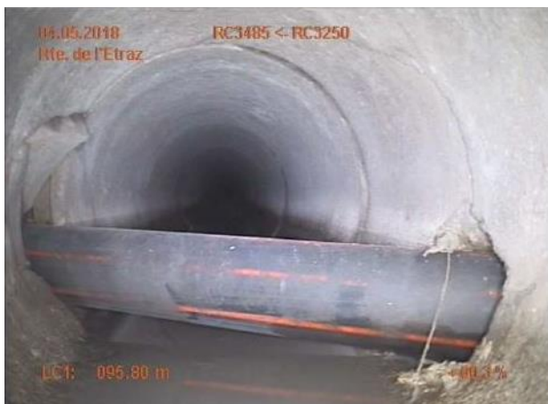
Conduite électrique traversant le collecteur EC
