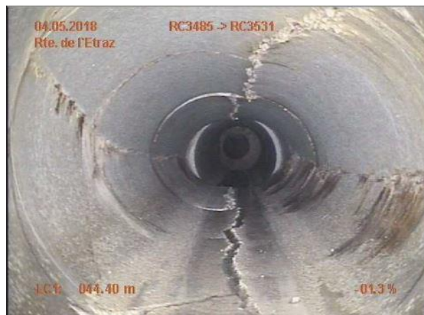
Collecteur EC éclaté sur 4 mètres
