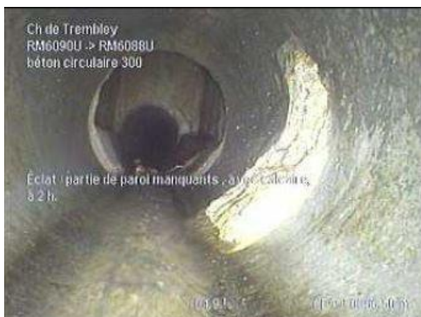
Infiltration d'eau claire dans les eaux usées
