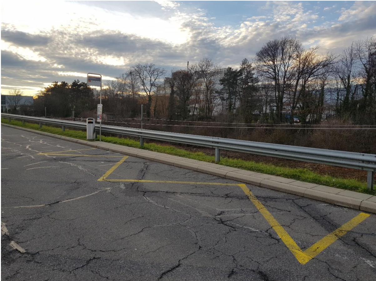
Fig. 4 - Dégradation de la couche de finition de la chaussée
