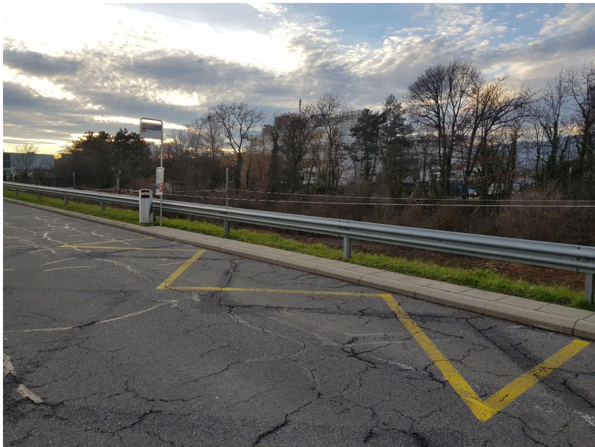
Arrêt des Mélèzes – vue sur l'arrêt Nord – Dégradation de la couche de finition
