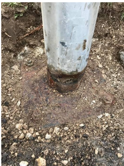
Fig. 5 - Pied d'un mât fortement corrodé
