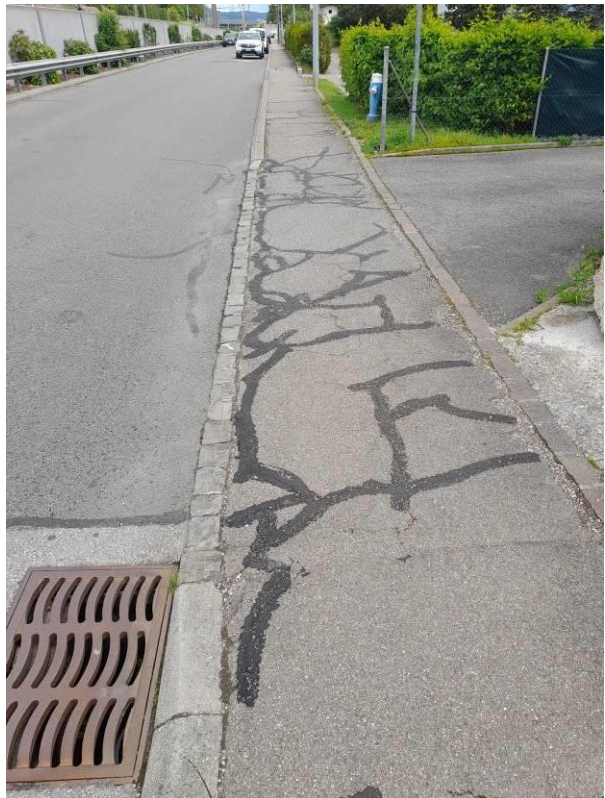
Fig. 5 - Traitement fissure au droit d'un accès privé
