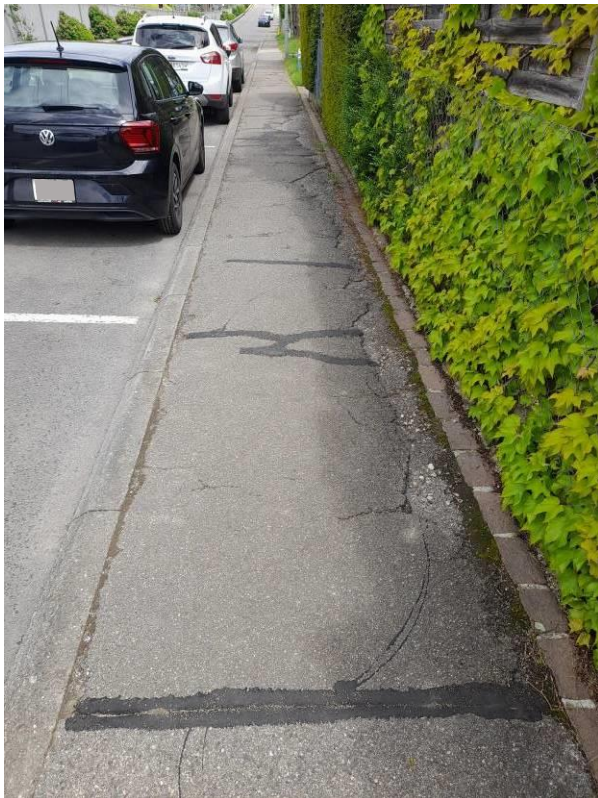
Fig. 4 - Dégradation de la couche de surface
