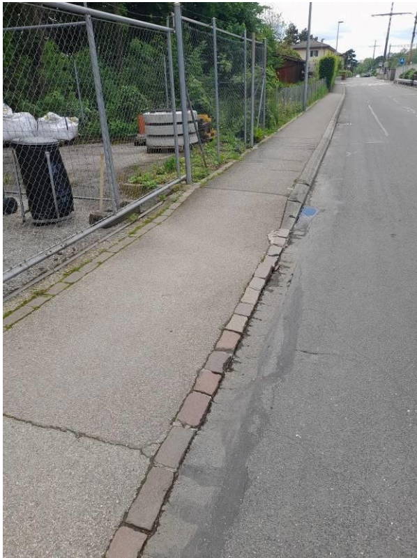
Fig. 2 - Affaissement du rang de pavé
