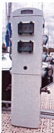
Installations similaires de bornes électriques
