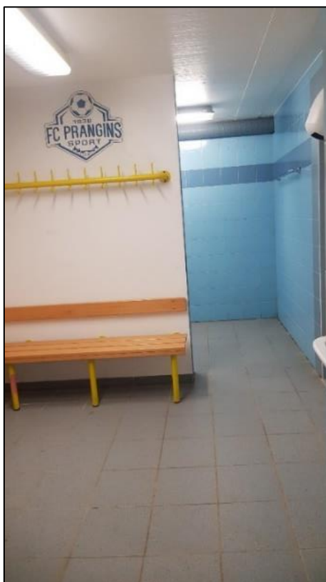
Fig. 3 - Vestiaires nécessitant des travaux de modernisation
